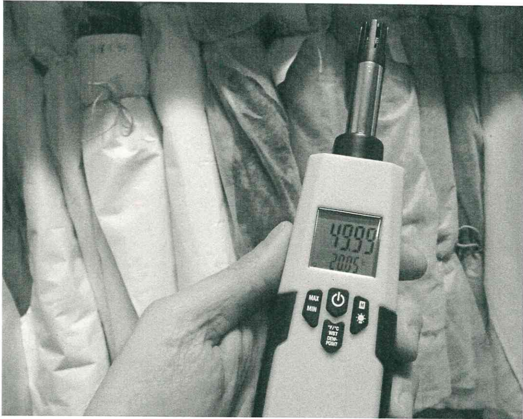
A beüzemelt páramentesítő ellenőrzése
